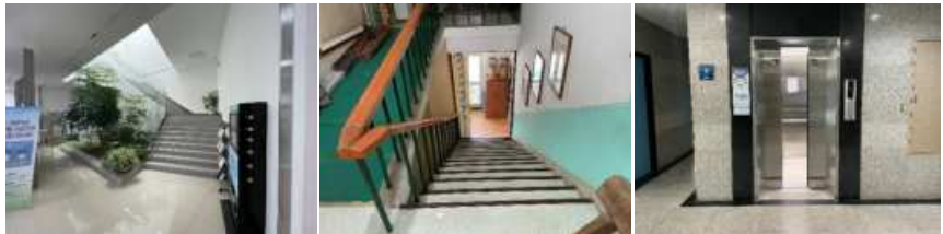
경사로 또는 승강기가 설치되지 않아 교통약자의 층간 이동환경 열악
