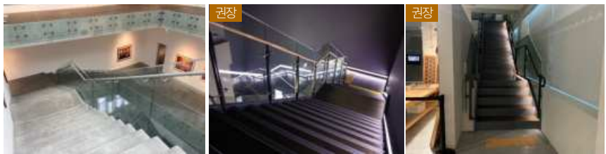
지양: 미끄럼방지 시설 부재
