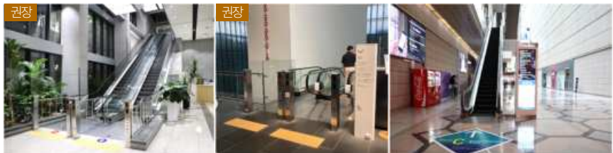
권장: 수평이동손잡이, 펜스, 진입방지 게이트 등을 기준에 맞게 설치
