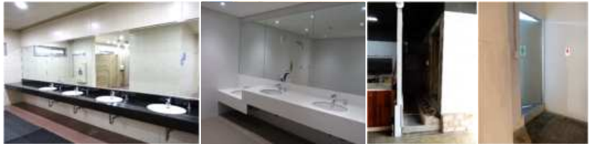
높이가 동일한 다인용 세면대 어린이의 이용한 배려한 세면대 바닥의 단차로 인해 사용이 불편한 화장실
