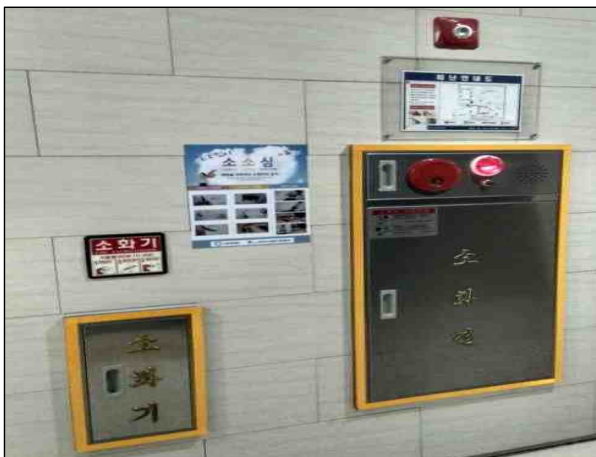
【소화기 및 피난안내도 개선】
