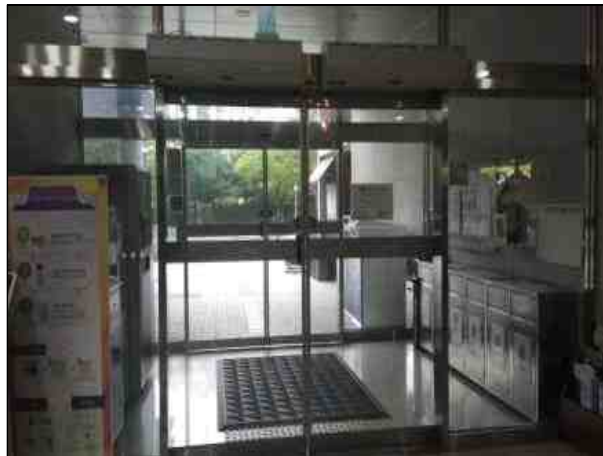
【내부 에어커튼 설치】
