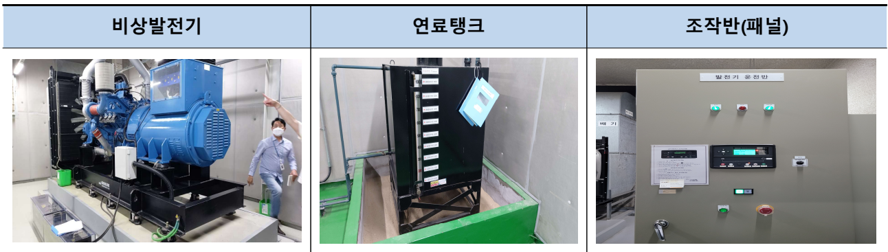
[사진 1] 비상발전기 설치 현황
