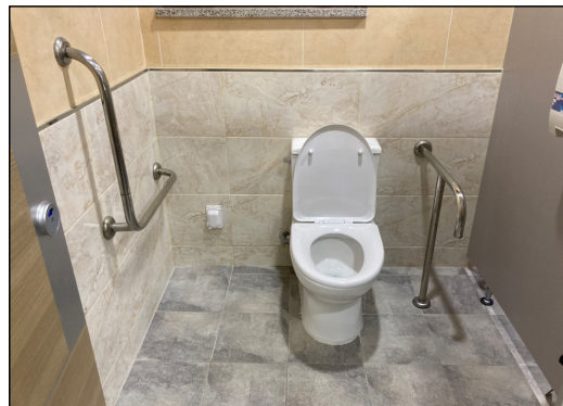
[그림 IV-29] 장애인 화장실 설치 오류
